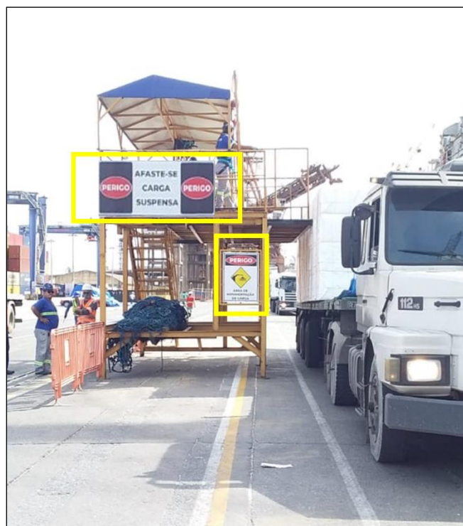
Figura 4 - Ilustração de sinalização de segurança nas plataformas de trabalho em altura, com os dizeres: PERIGO, AFASTE-SE CARGA SUSPensa e AFASTE-SE MOVIMENTAÇÃO DE CARGA.
